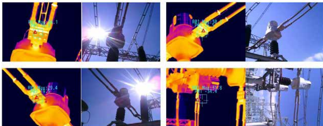
图11：多光谱智能巡检系统巡视发现缺陷
