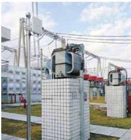
图：方电网变电站WAPI应用现场
